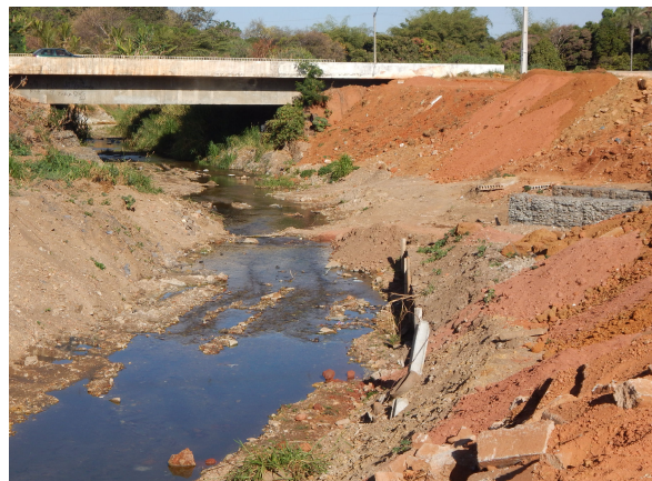
Figura 3 - Obras inacabadas na bacia do córrego Tamanduá. Fonte: Fotografia pelo autor, 2017.
