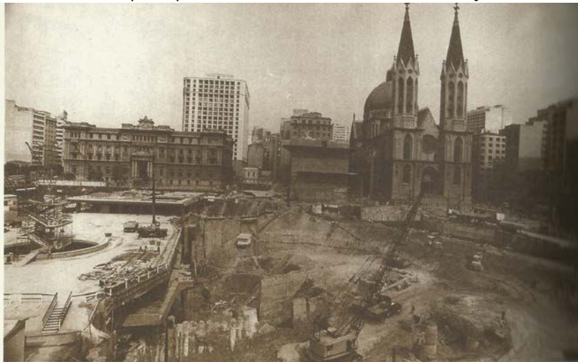
Figura 10: Canteiro de obras da estação da Sé, o vazio do lado esquerdo da neogótica Catedral da Sé, coincide com a área antes ocupada pelo Palacete Santa Helena e edificações circunvizinhas.
