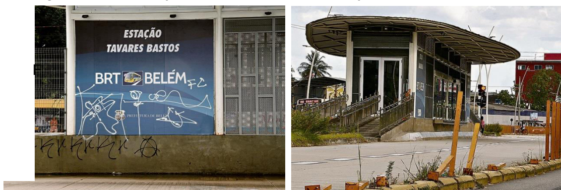
Figuras 16 e 17: Pichações e roubo das cercas das estações concluídas do BRT Belém
