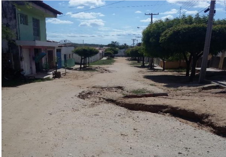
Figura 08. Condições das vias do Ato da Tubiba.
