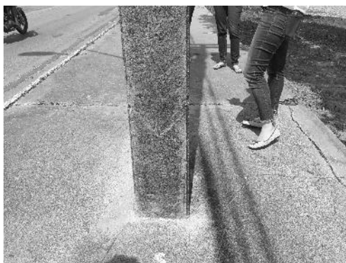
Figura 10. Poste posicionado fora da faixa de serviço.
