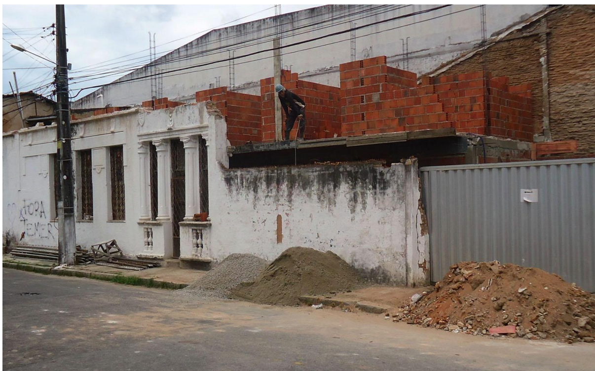
Figura 17: Demolição de imóvel histórico registrada no cruzamento da Avenida Visconde do Rio Branco e Rua Adolfo Siqueira.
