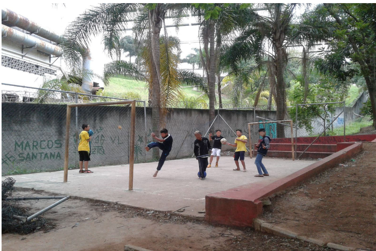
Figura 12: Crianças brincam na quadra já deteriorada. Fonte: Autor
