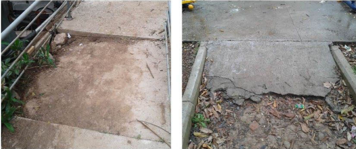
Figura 14: Patamar cedendo e acesso ao patamar da área de ginástica. Fonte: Autor
