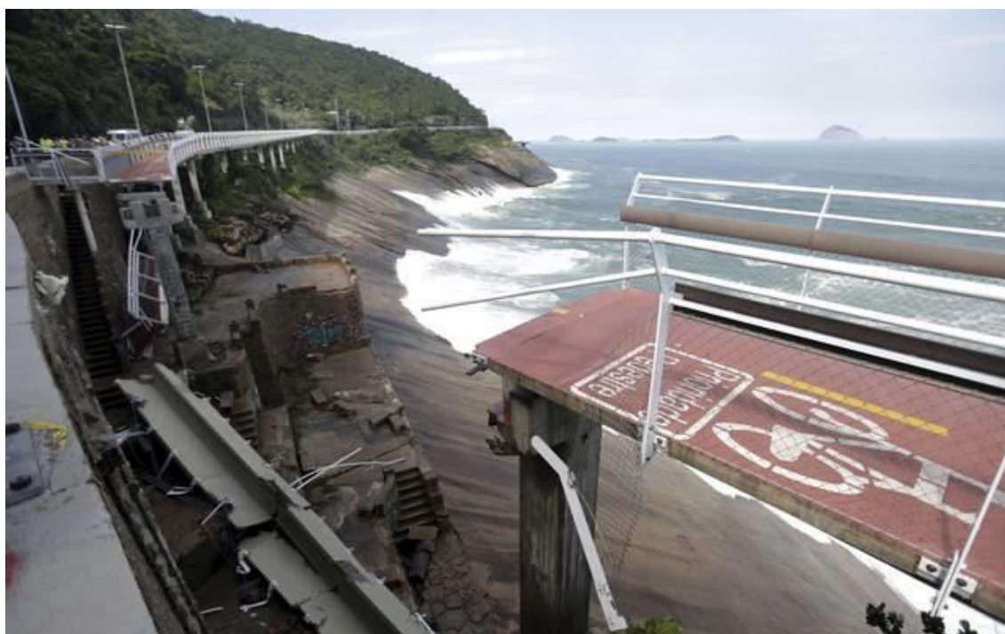
Imagem 7. Imagem da Ciclovia Tim Maia após o desabamento em 2016
