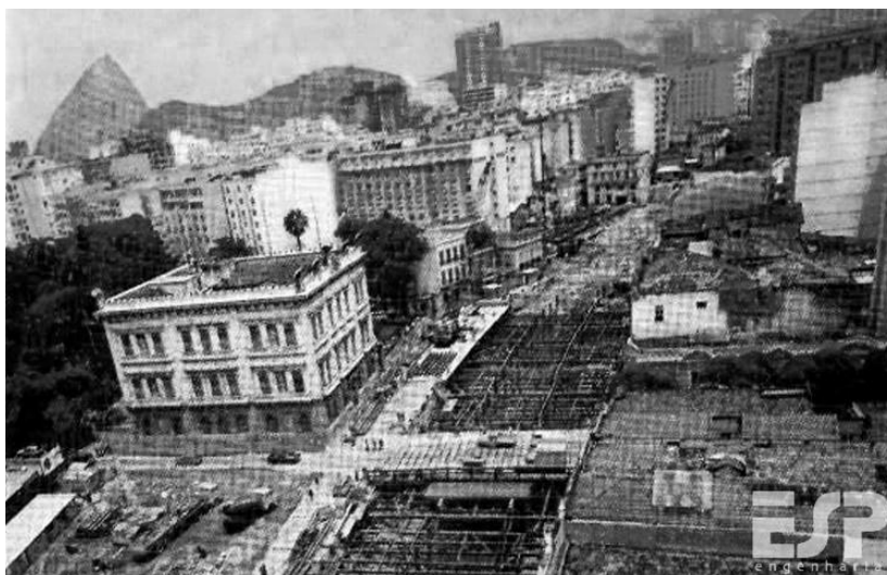
FIGURA 1 - A foto acima mostra a obra do metrô na altura da Rua Silveira Martins em frente ao Palácio do Catete, podemos notar o terreno vazio onde se encontrava antes a Escola Rodrigues Alves.
