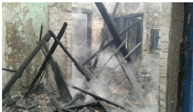
Villa Nenê após incêndio
