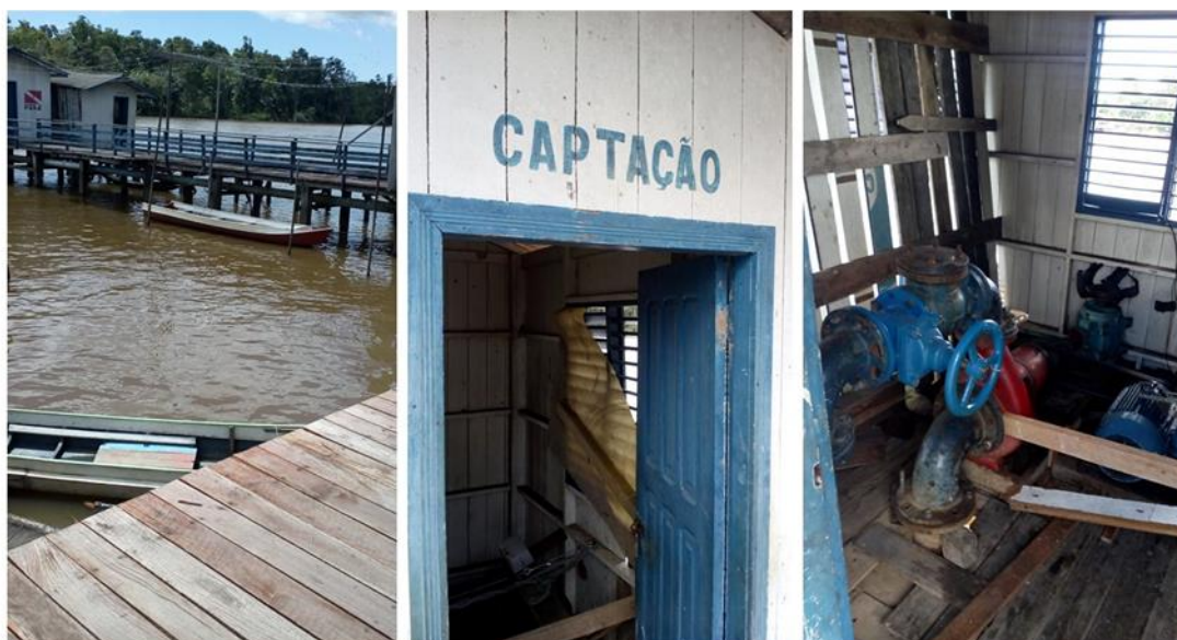
Figura 5 – Situação do sistema de captação de água em Afuá/PA Fonte: Laboratório de Estudos das Cidades, 2018.
