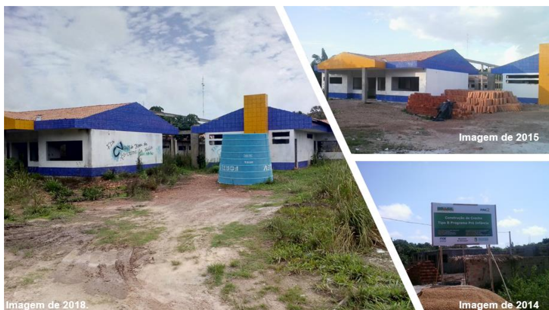
Figura 6 – Obra abandonada em Ponta de Pedras/PA. Imagem de 2014 com a placa de divulgação da obra; em 2015 obra já parada, mas com a presença de materiais. No ano de 2018, já configurada uma obra abandonada.
