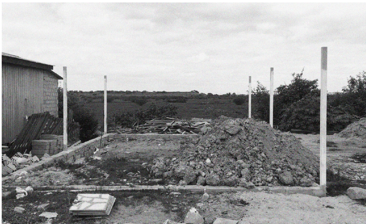
Figura 5. Pilares e fundações da nova associação de moradores da Vila Dique. (Foto: EMAV, 2018)
