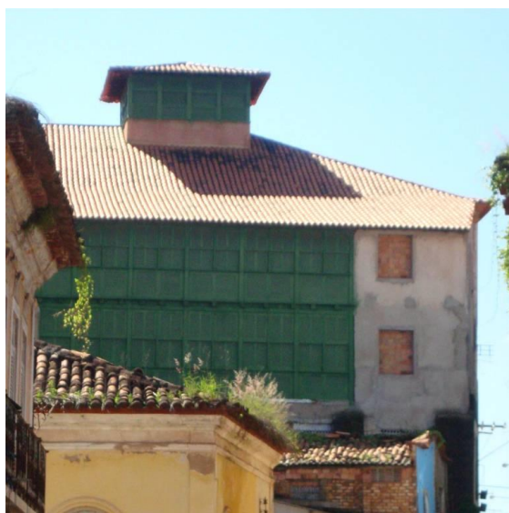
Foto 1 - Fachada posterior do sobrado situado a Praça João Lisboa, Nº37 (A Pacotilha) Fonte: Lena Carolina A. F. Ribeiro Brandão
