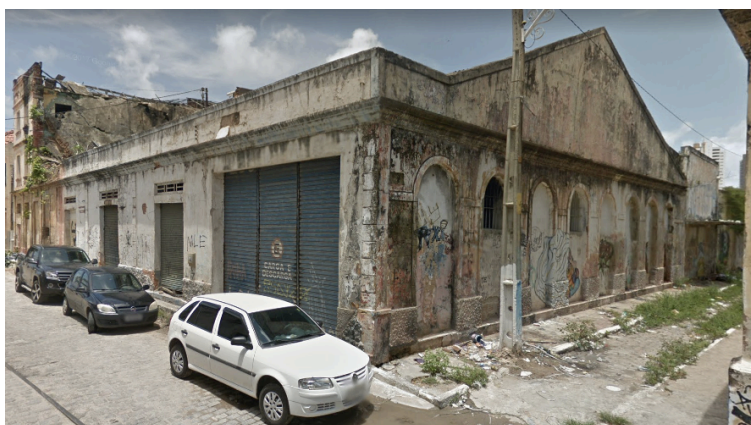
Figura 5 - Edifícios degradados na Rua Chile
