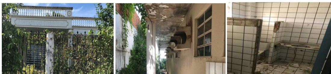
Imagens 28 a 30 - Exemplo de imóvel desocupado a ser avaliado pela destinação. Localizado no Ceará, apresenta problemas construtivos. Fonte: SPU, 2018.
