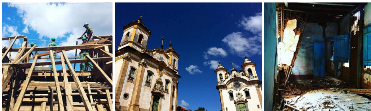
Figuras 4, 5 e 6: Em Mariana/MG - Obras em execução na Catedral da Sé, à esquerda; Praça Minas Gerais com a Igreja de São Francisco em primeiro plano interditada há cinco anos, no centro; Casa do Conde de Assumar em ruínas, à direita.
