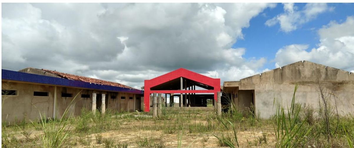
Figura 1: Creche abandonada no Conjunto Habitacional Maria de Nazaré em Atalaia, Alagoas.
