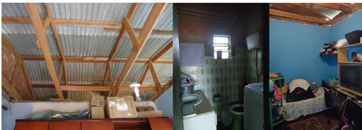
Figura 7: Imagens do telhado sem forro, do banheiro e de um dos quartos. Fonte: ASCPOA.
