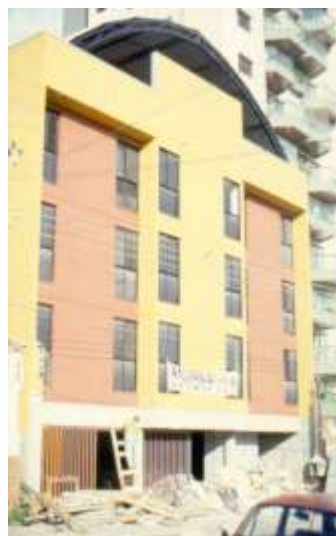
Imagem 4 – Empreendimento Casarão Celso Garcia localizado na região central do município de São Paulo. Programa de mutirão do município de São Paulo. Assessoria técnica Ação Direta (AD). Fonte: acervo assessoria AD.
