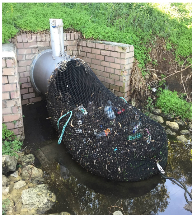
Figura 13 – Exemplo de rede para captura de resíduos sólidos instaladas em tubos de drenagem de concreto na cidade de Kwinana, na Austrália (março de 2018), com capacidade para cerca de 400 kg de detritos. Fonte: KWINANA (2018)
